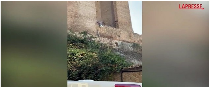
Cronaca Torre dei Conti, operai cercano di fuggire dopo il primo crollo
